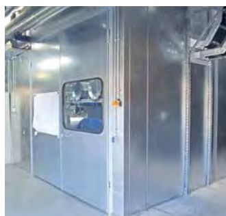
Das neue Modul steht im schallgedämmten Betriebsraum
